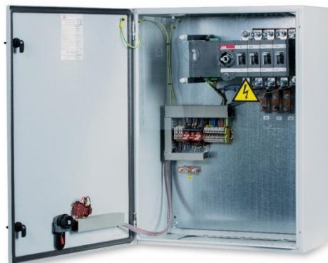
Щит АВР свыше 160А
