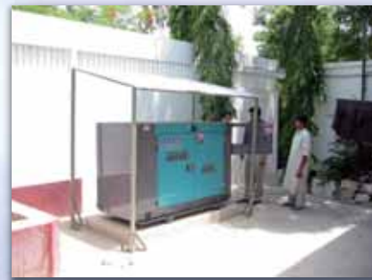
Как аварийный источник питания в больнице
